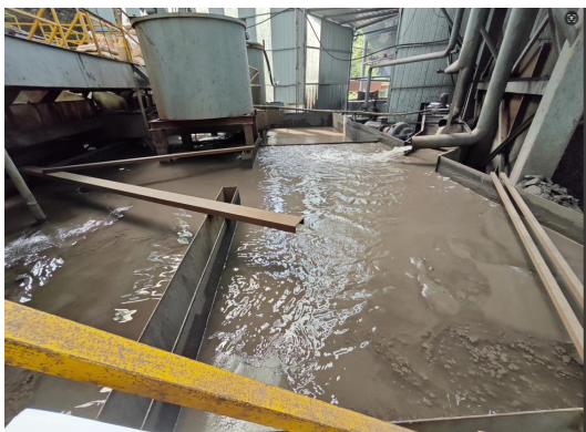
污水收集池 （2座 200m³，煤矸石洗选车间内）
