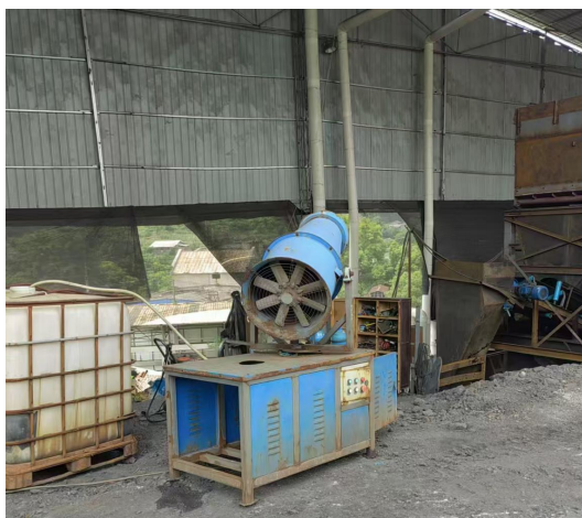
预处理平台-筛下煤矸石落料区雾炮机
