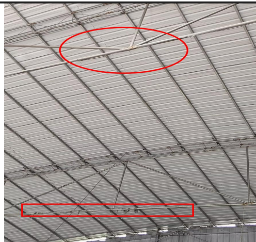
预处理平台屋顶喷雾装置
