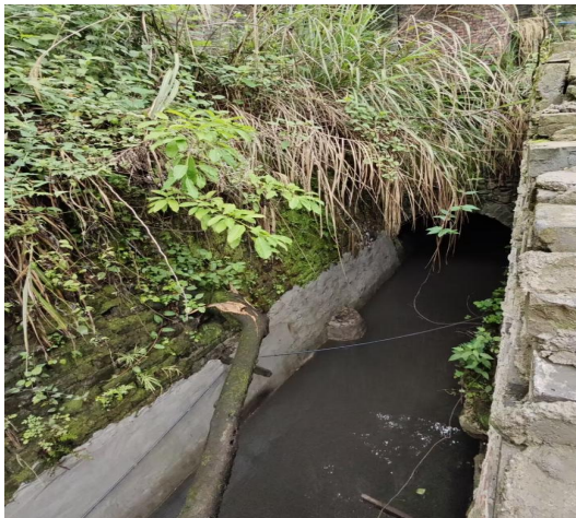
矸石山区域初期雨水收集渠
