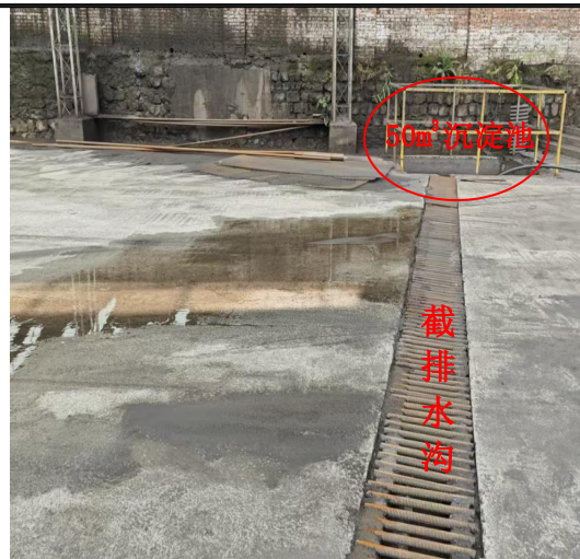
煤矸石洗选车间截排水沟、沉淀池（50m 3 ）
