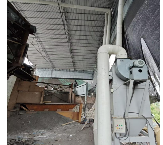
预处理平台-筛分废气收集管道及布袋除尘器
