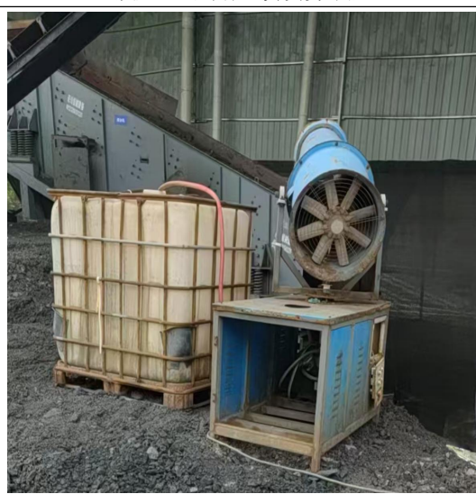
预处理平台-筛上煤矸石落料区雾炮机
