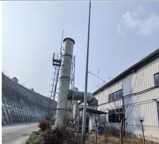
2#贮存库排气筒
