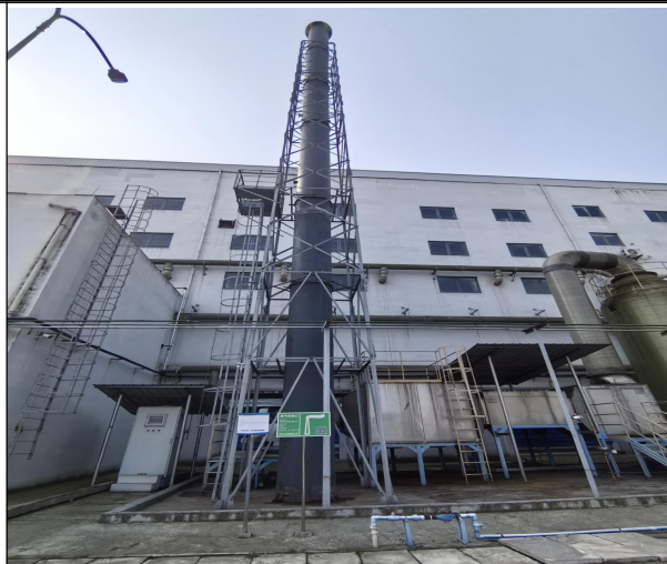
甲类仓库排气筒
